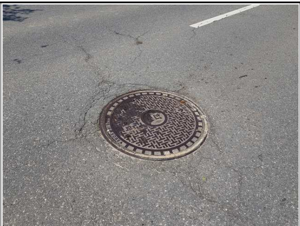
내용 도로포장 아스콘망상균열
