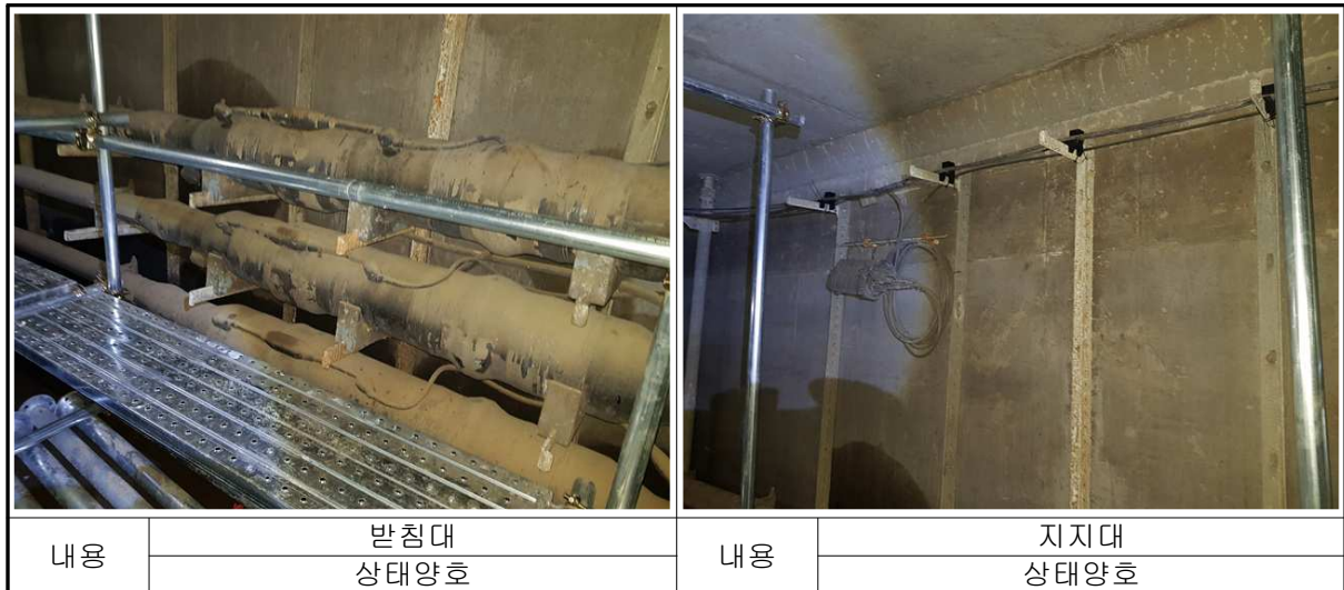
【사진 6.12】 부속 및 부대설비 현황
