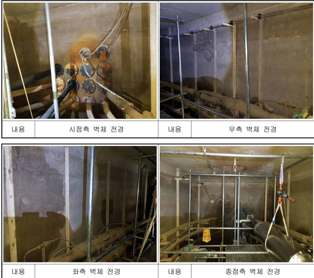
【사진 6.9】 문산~선유 #3 전경
