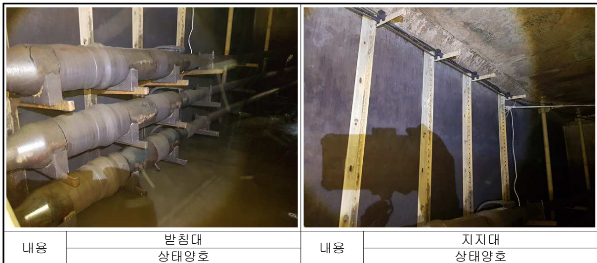
【사진 6.8】 부속 및 부대설비 현황
