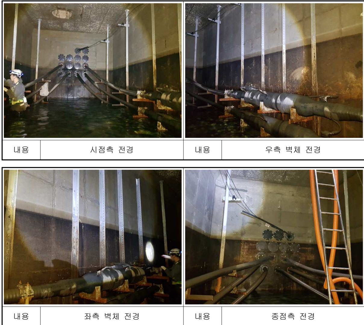
【사진 6.1】 문산~선유 #1 전경
