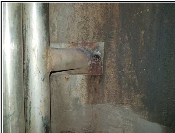
내용 추락방지시설 앵커볼트파손
