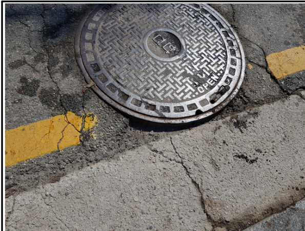
내용 도로포장 아스콘파손
